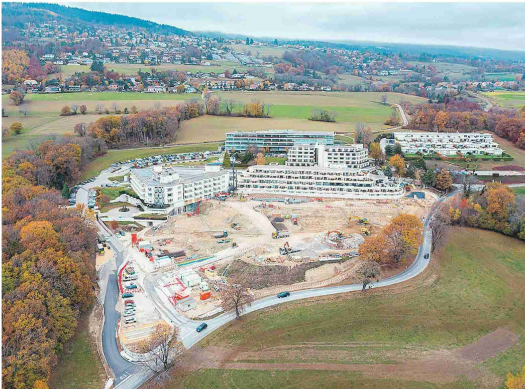
Genolier Innovation Hub. La construction du nouveau bâtiment, sur le site de la clinique, a débuté en juin. La première pierre du projet a été symboliquement posée lundi.
